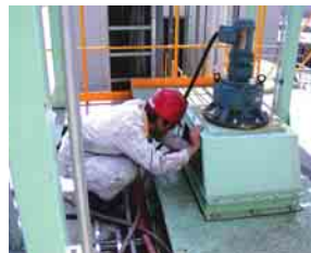
排水処理担当者が設備管理中
