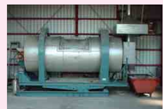
汚泥乾燥装置外観
