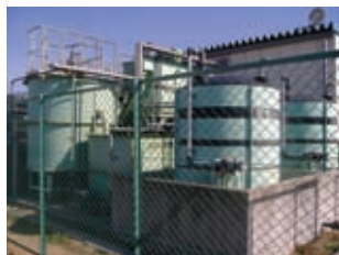
加圧浮上装置
