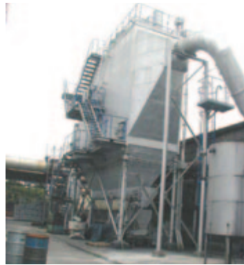
燃焼排ガス処理を行う電気集塵機
