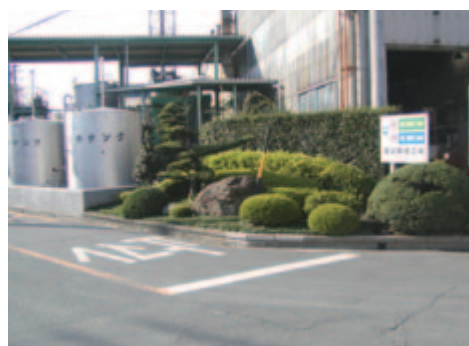
重油貯蔵タンクから溶解工場に続く配管は、すべて地上で監視しています
