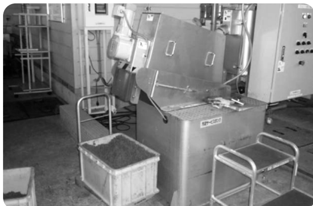
余剰汚泥脱水機
